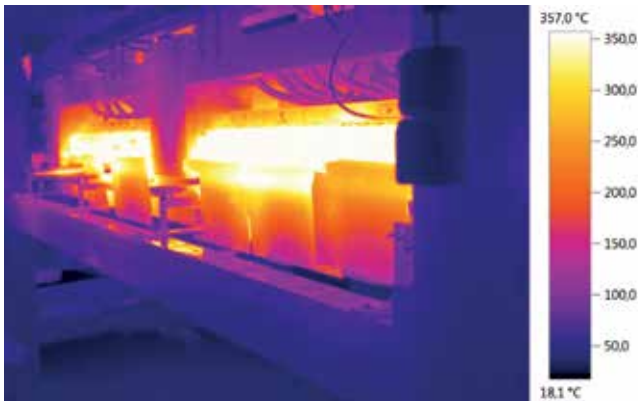
Mit einer Wärmebildkamera lassen sich auch Anlagen in einem hohen Temperaturbereich überwachen.
