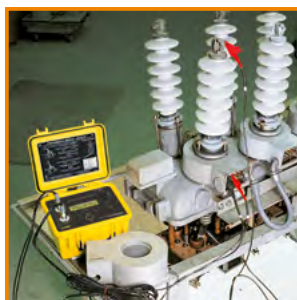
Messung des Wandlerverhältnisses an einem Stromwandler
