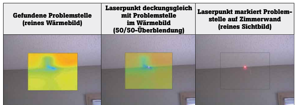
Abb. 7. Eine Problemstelle ist durch Wärmebildung ermittelt worden. Die Zuordnung eines Laserpointerpunkts im überblendeten Bild stellt sicher, dass der Laserpunkt auf dem Messobjekt das gewünschte Detail markiert
