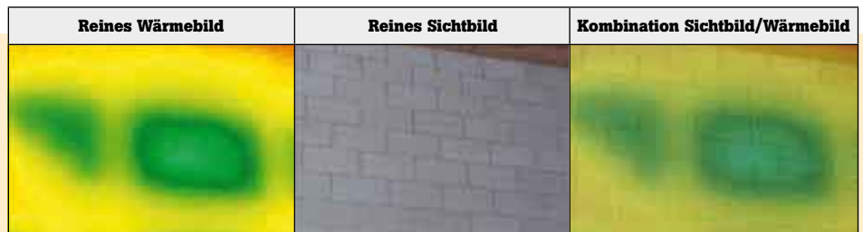
Abb. 1. Die Stelle mit fehlender Füllung in einer Porenbetonwand ist über die Kombination von Wärme-/Sichtbild einfach zu identifizieren
