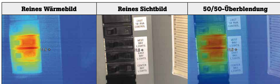
Abb. 6. Betriebsmittelbeschriftungen und die Problemstelle können in einem kombinierten Wärme- und Sichtbild erkannt werden
